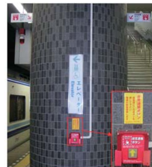
非常通報ボタン
