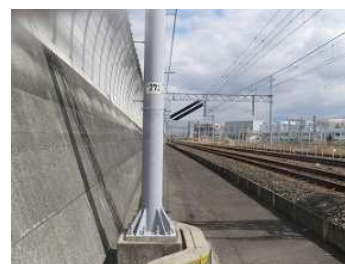
架線区分標識（エアセクションの位置を示す）
